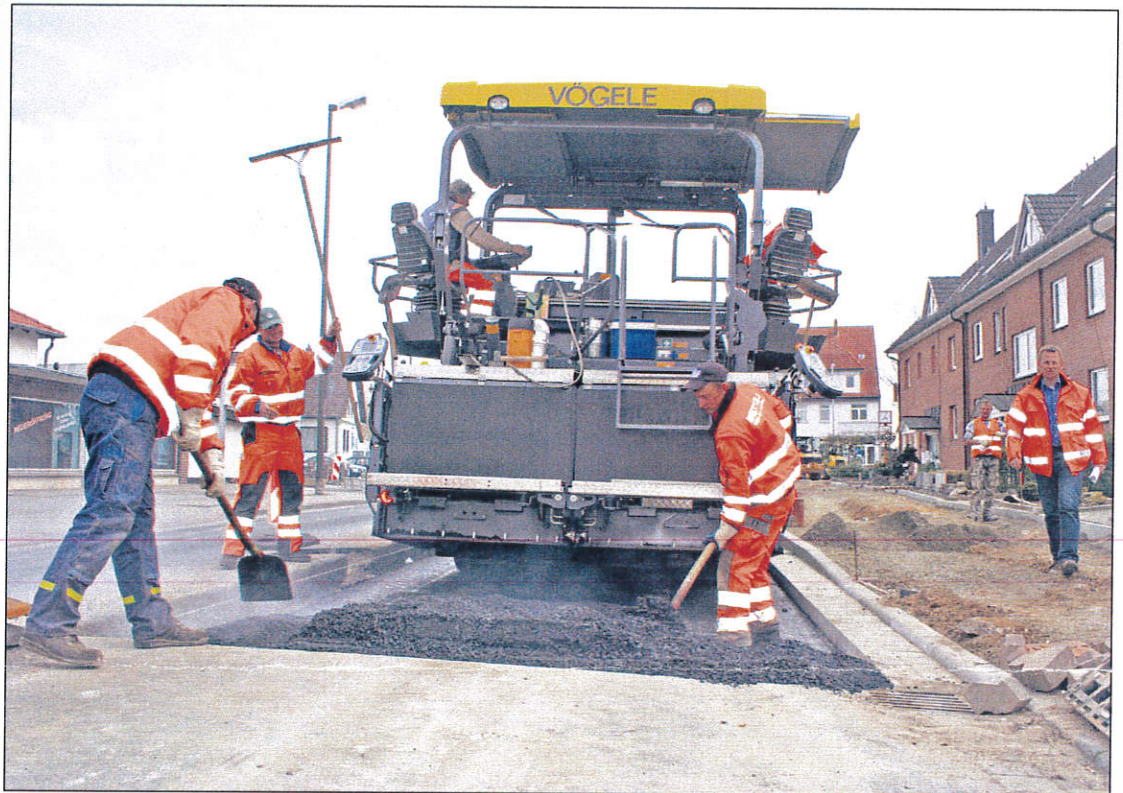
Mitarbeiter der Baufirma Bettels aus Hildesheim asphaltieren die Straße Am Pferdemarkt in Richtung Walsroder Straße.
